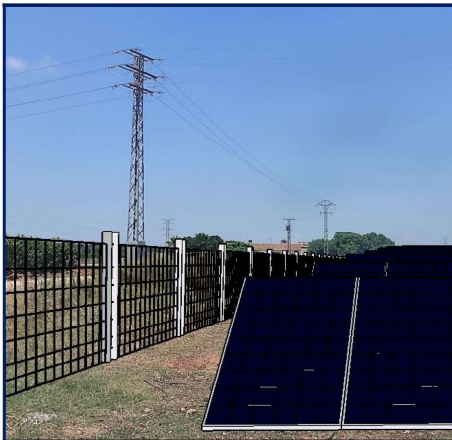
Imagen 10: vista de la planta fotovoltaica en la zona norte desde linde de parcela
